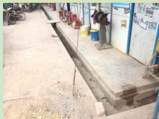
总包办公区部分排水沟
