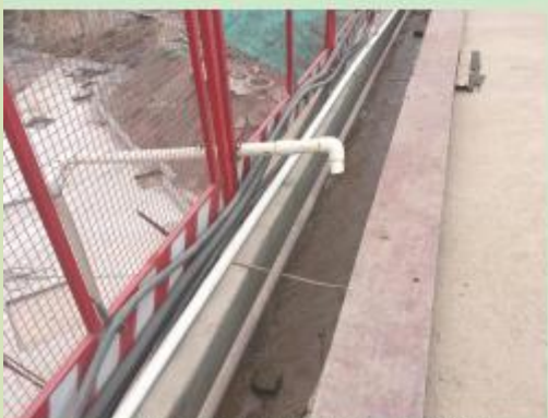
基坑周边部分抽排水设施 1
