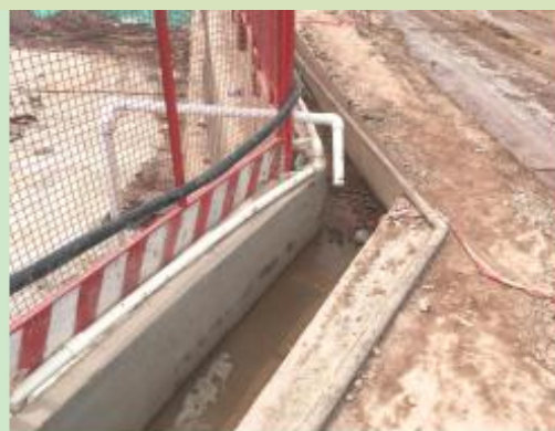
基坑周边部分抽排水设施
