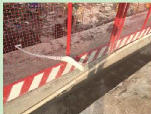
基坑周边部分抽排水设施 2
