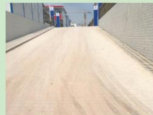
总包办公区出入口排水硬化现状
