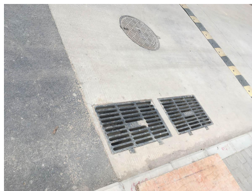
道路路面雨排水设施 1
