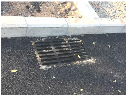
道路路面雨排水设施 2
