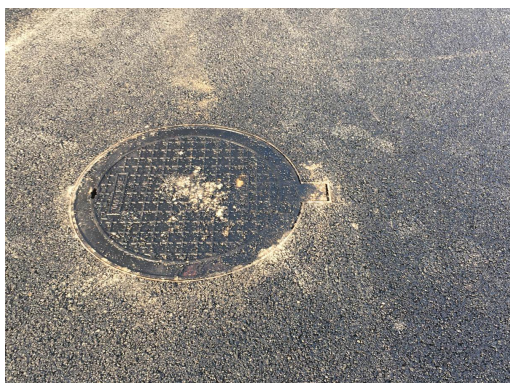
道路路面雨排水设施 4
