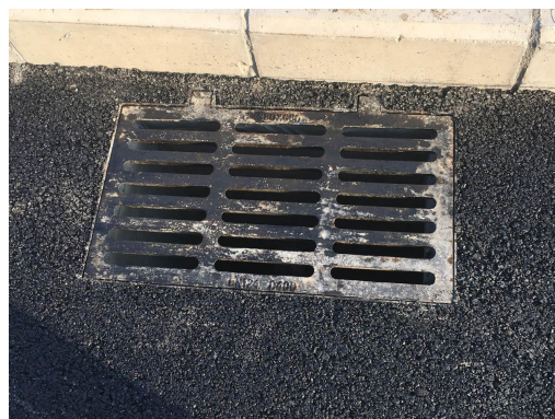
道路路面雨排水设施 5
