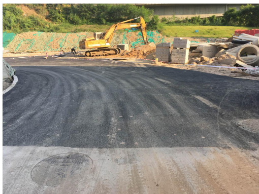
道路路面硬化现状 1
