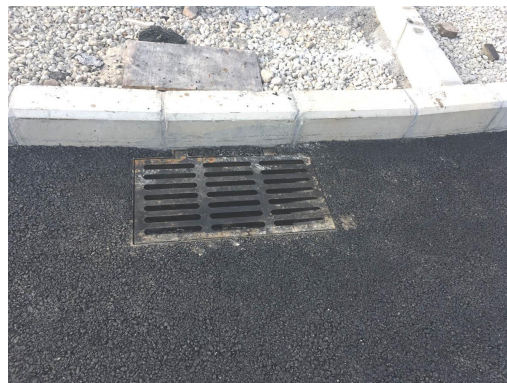
道路路面雨排水设施 3
